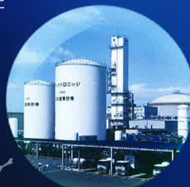
液化水素製造プラント
